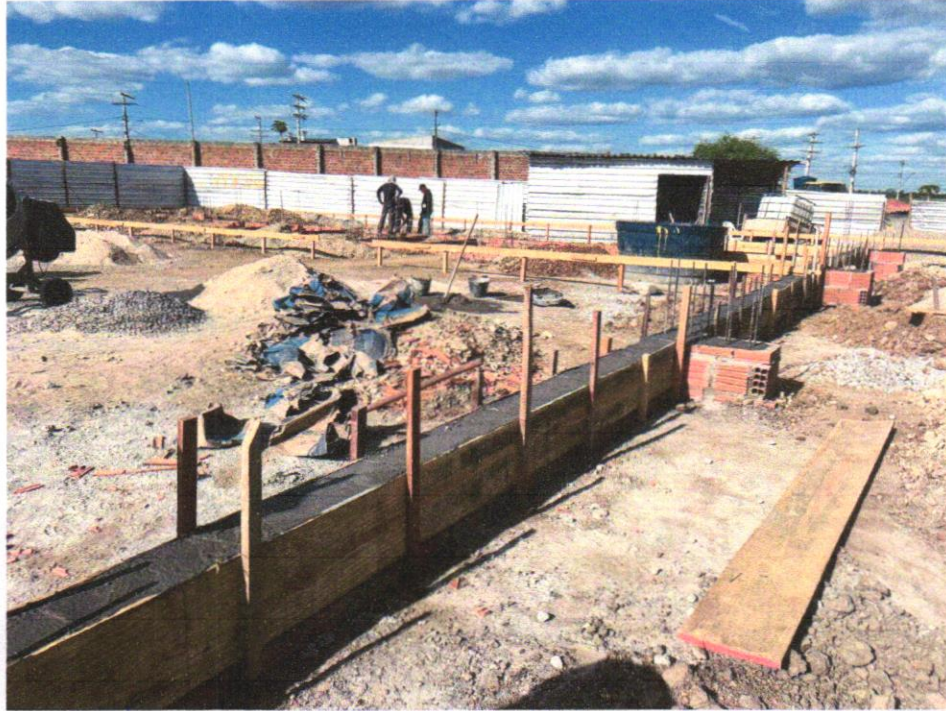
IMAGEM 01 - FABRICAÇÃO, MONTAGEM E DESMONTAGEM DE FÔRMA PARA VIGA BALDRAME, EM CHAPA DE MADEIRA COMPENSADA RESINADA, E=17 MM, 4 UTILIZAÇÕES. AF_06/2017
