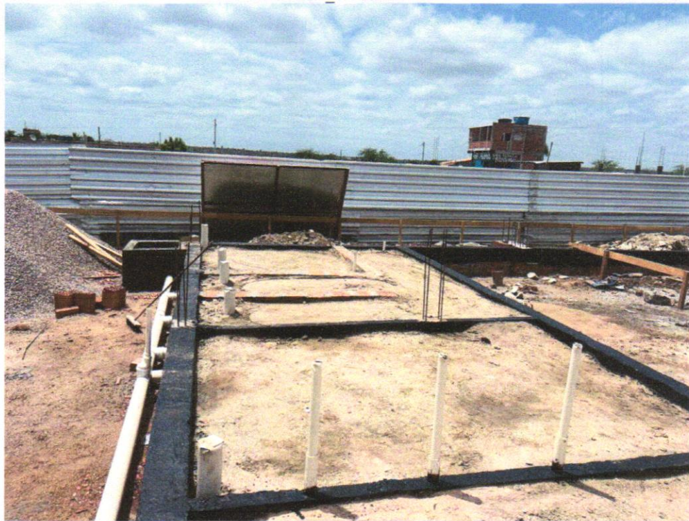
IMAGEM 14 – CORTE E DOBRA DE AÇO CA-50, DIÂMETRO DE 8,0 MM, UTILIZADO EM ESTRUTURAS DIVERSAS, EXCETO LAJES. AF_12/2015
