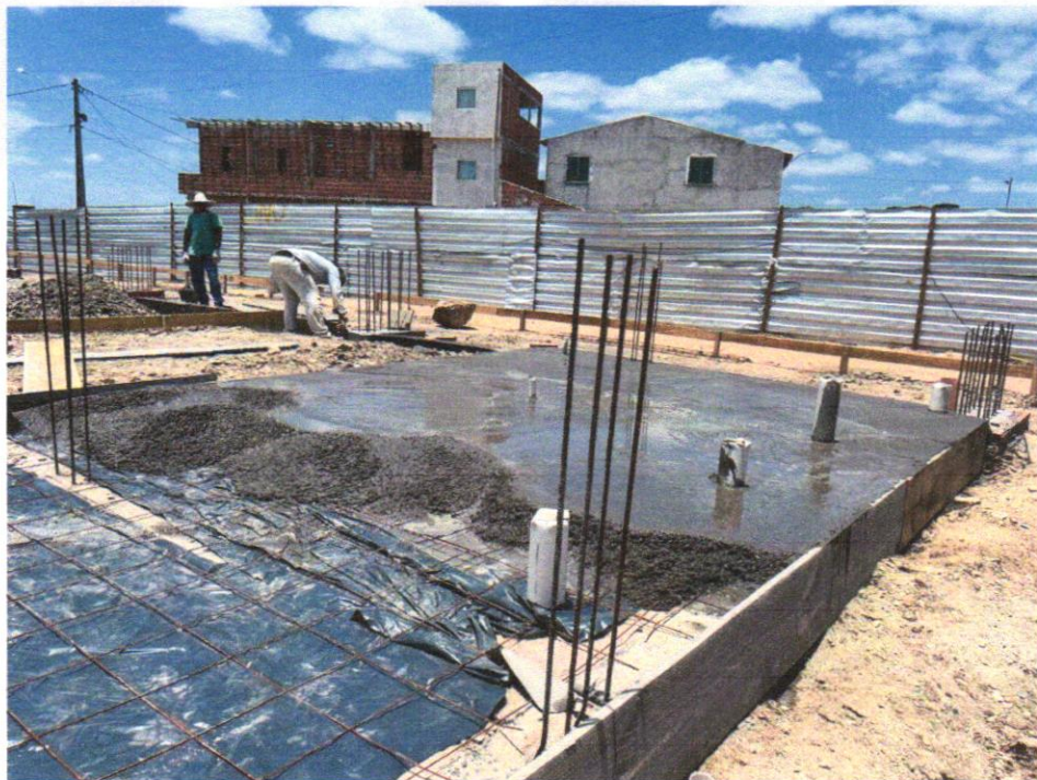
IMAGEM 08 - ARMAÇÃO PARA EXECUÇÃO DE RADIER, PISO DE CONCRETO OU LAJE SOBRE SOLO, COM USO DE TELA Q-92. AF_09/2021
