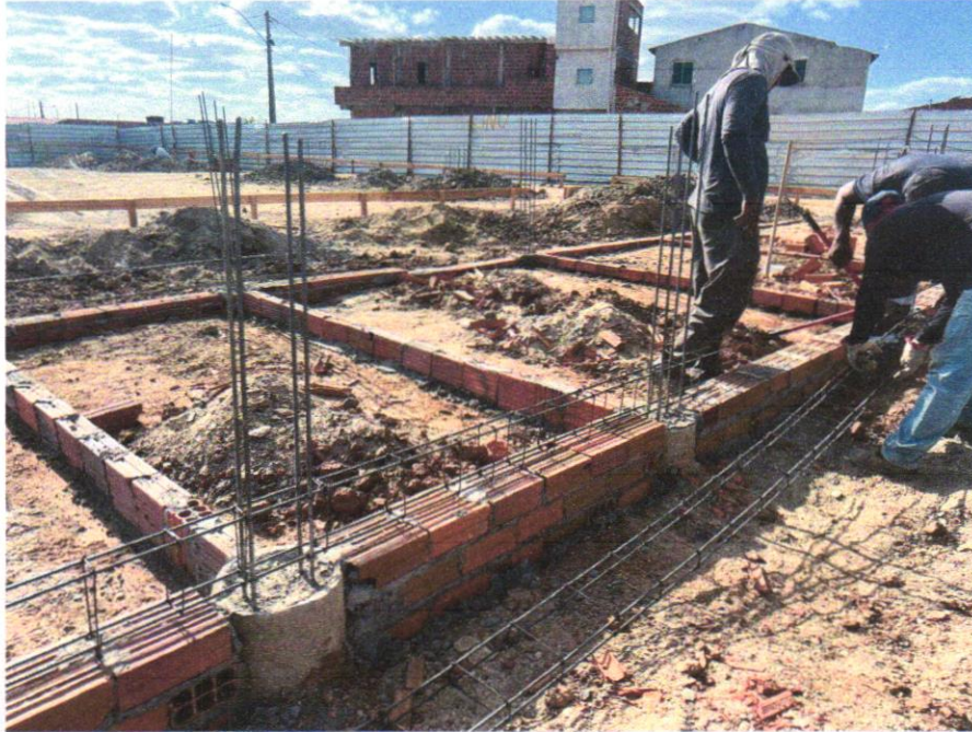
IMAGEM 05 - CORTE E DOBRA DE AÇO CA-50, DIÂMETRO DE 8,0 MM, UTILIZADO EM ESTRUTURAS DIVERSAS, EXCETO LAJES. AF_12/2015
