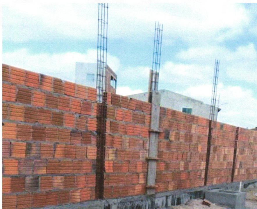
IMAGEM 12 – ALVENARIA DE VEDAÇÃO DE BLOCOS CERÂMICOS FURADOS NA HORIZONTAL DE 9X19X19 CM (ESPESSURA 9 CM) E ARGAMASSA DE ASSENTAMENTO COM PREPARO MANUAL. AF_12/2021
