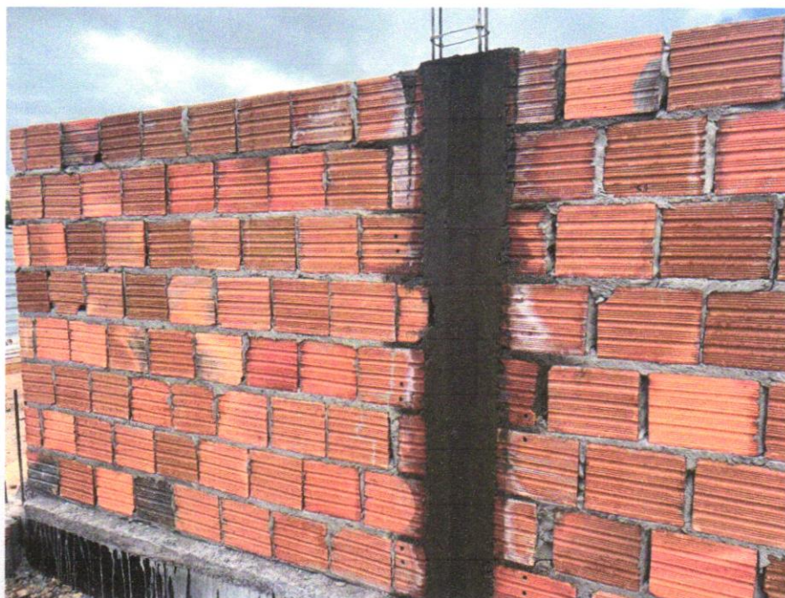
IMAGEM 11 – ALVENARIA DE VEDAÇÃO DE BLOCOS CERÂMICOS FURADOS NA HORIZONTAL DE 9X19X19 CM (ESPESSURA 9 CM) E ARGAMASSA DE ASSENTAMENTO COM PREPARO MANUAL. AF_12/2021
